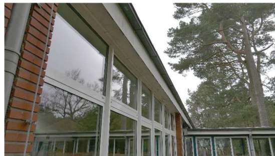
Blick unter den Dachüberstand der 1-geschossigen Schulgebäude: die Anschlüsse sind dicht, Spaltenräume nicht offensichtlich
